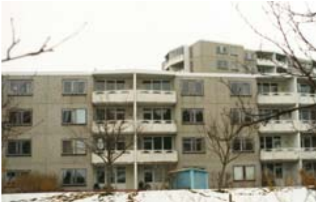
Bild 69. Navestad, som området hette i folkmun, hade ett stor underhållsbehov innan projektet genomfördes. Foto: Jenny Stenberg.
